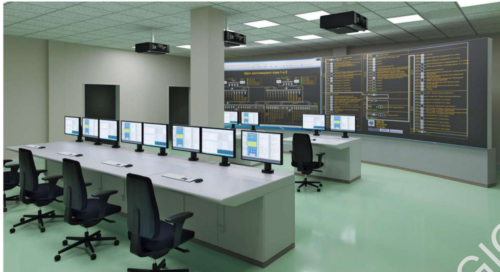
Центральный диспетчерский пункт. Белорусская АЭС
